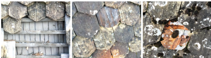
Zustand der Lattung und Ziegeleindeckung
