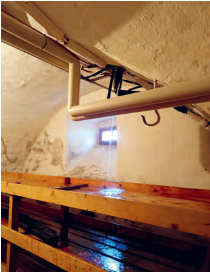
Austretendes Abwasser im Keller
