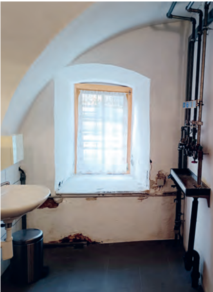
Abbröckelnder Verputz im Technikraum
