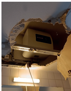
Tropfender Boileranschluss im WC Kirche Azmoos (Boiler war nicht zugänglich und Decke musste demontiert werden)
