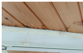
Austretendes Wasser an der Decke
