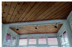
Undichte Decke im Wintergarten
