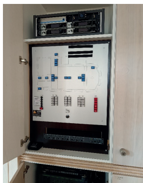
Erweiterung der Audioanlage in der Kirche Azmoos
