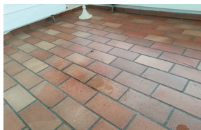
Wasserpfütze im Wintergarten verursacht durch die undichte Decke
