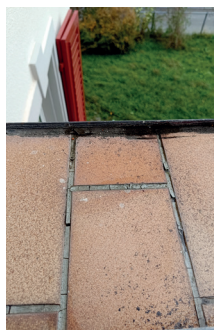
Terrassenboden gesprungene Fugen
