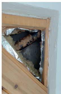
Die geöffnete Decke zeigt einen durch-nässten Betondeckel
